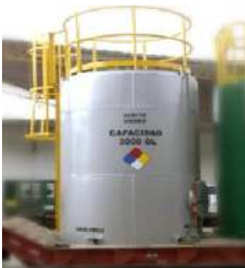
Tanques de almacenaje.
